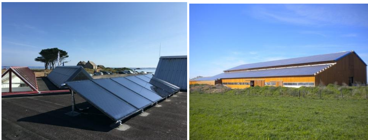
Figure 30 : modules solaires thermiques (Installation de la Maison de la Mer de Plougerneau) versus installation photovoltaïque en toiture
